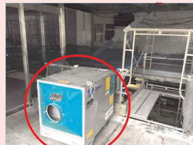
集塵機を設置し室内の換気を実施
